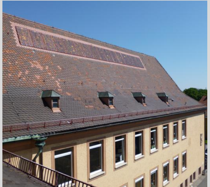
Bild 5: PV-Anlage auf der Regenbogenschule
