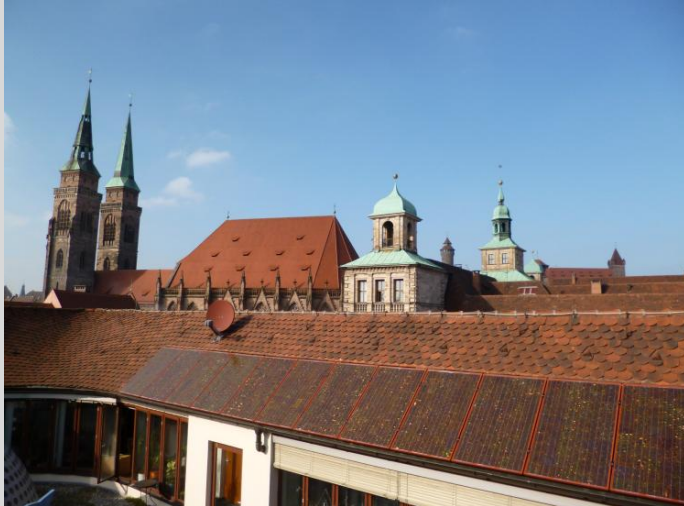
Bild 1: PV-Anlage auf dem Neuen Rathaus, Hauptmarkt 18
